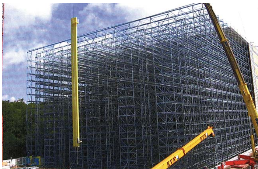
Фото 1. Конструкция высотных стеллажей-опор склада-холодильника
