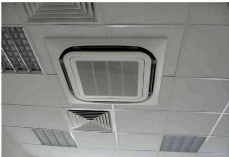
Внутренний блок кондиционера в VIP зале аэропорта «Внуково – 1»
