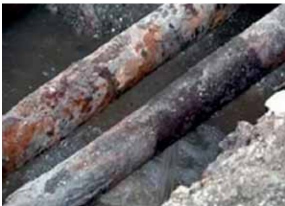
Поверхностная коррозия трубопроводов.
