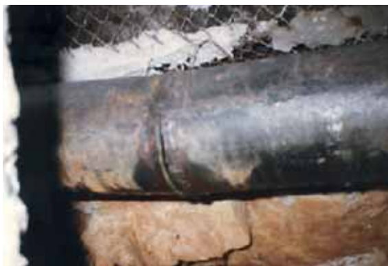
Разрушение трубопровода под воздействием ледовой нагрузки.
