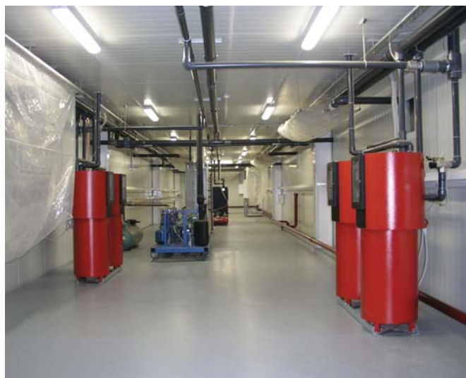
Оборудование РА и холодильное в технологическом коридоре, расположенном над транспортным на холодильнике предприятия «Выселковское» в Краснодарском крае
