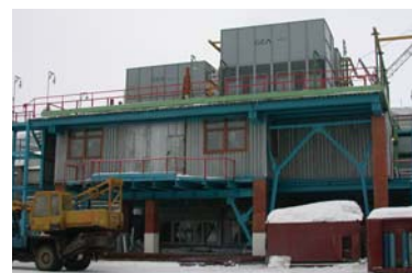
Фото. 3 Блок испарительных конденсаторов холодильной установки на производственной площадке пивоваренного завода
